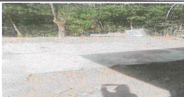
Foto 3: Losa en malas condiciones
