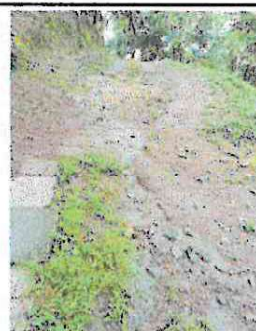
Foto 4: Cuneta en mal estado debido a la corriente de agua
