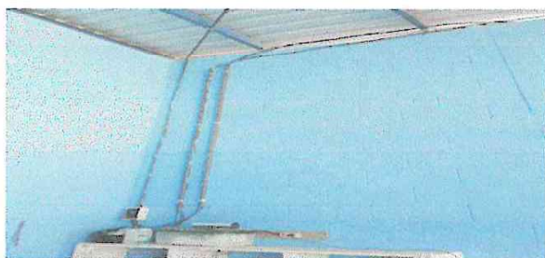
foto : 5 Mala distribución de energía eléctrica
