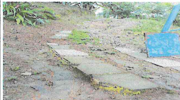
Foto 2: Ingreso de cemento a la escuela destruido por la corriente de agua
